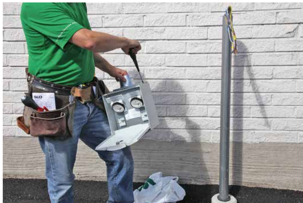
Uusia pistorasiakoteloita asennettaessa kannattaa huomioida myös sähköautojen lataustarpeet. Tarjolla on myös sähkömittauksella ja vikavirtasuojilla varustettuja ratkaisuja.
