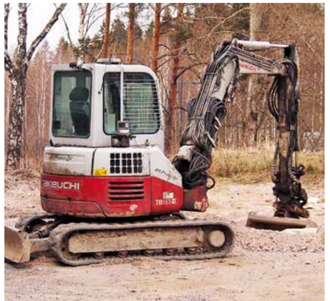
Kun maatöitä tehdään pintaa syvemmillä alueilla, jossa maassa voi olla sähkö- ja tietoliikennekaapeleita, vesijohtoja tai kaukolämpölinjoja, selvitä aina niiden paikat ennen kaivutöiden aloittamista. S. 12
